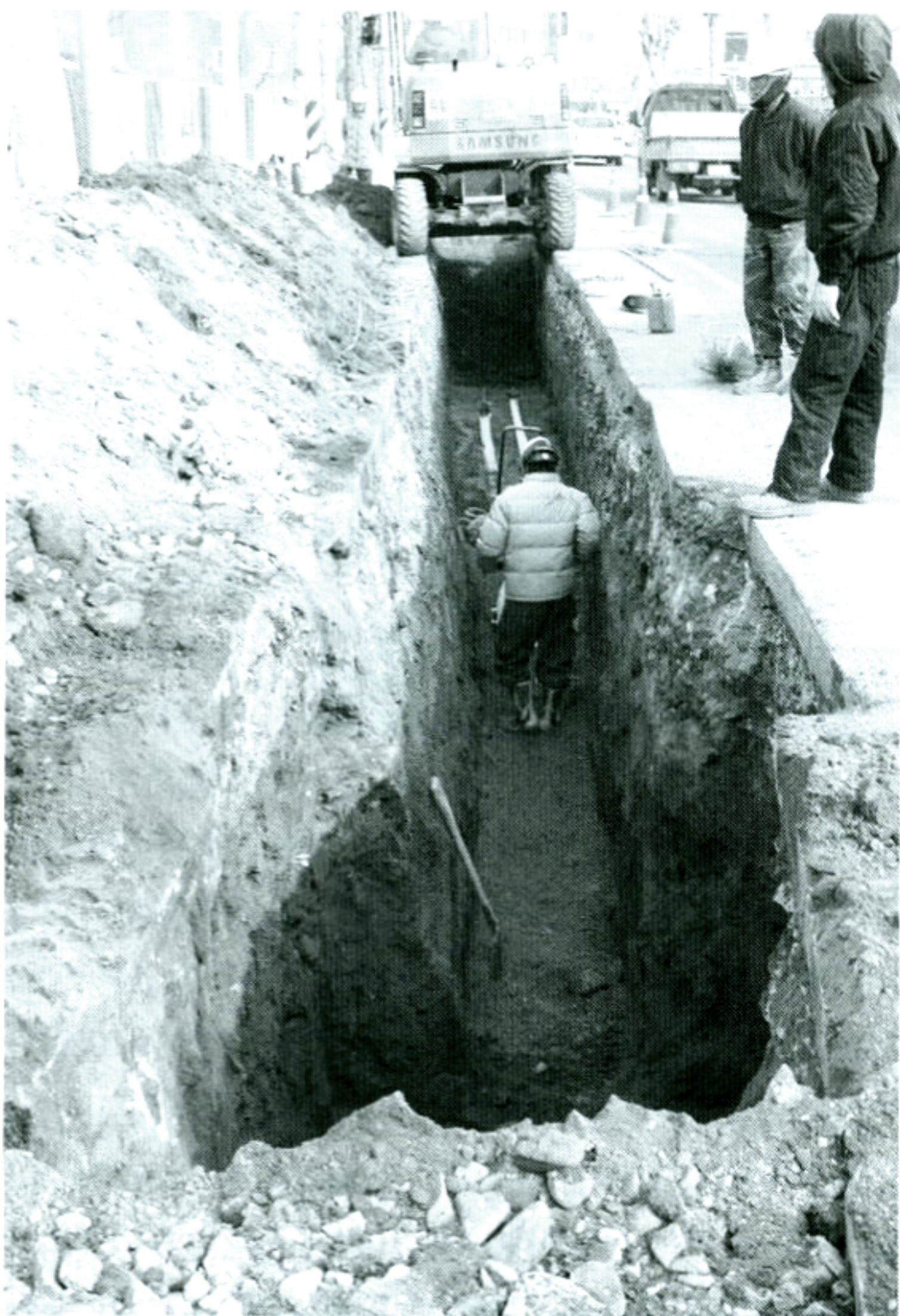
▲올해 하수관거 BTL사업이 16개 지자체에서 연장 1천617km, 사업비 1조1천579억 원 규모로 이달부터 시행된다. 사진은 강화군 강화읍 지역 BTL 하수관거 정비사업 모습.
